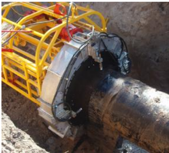
Рисунок 2 – Робоча зона напівавтоматичного очищувача із роторними струминними головками. Видні плями залишкового забруднення на трубопроводі
