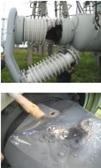
Рисунок 4 – Пошкоджений ввід та литий ізолятор вимикача 750 кВ
