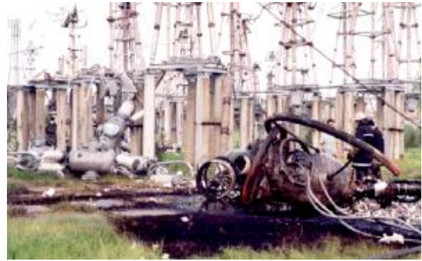
Рисунок 1 – Пошкоджений вимикач типу ВВБ-750 на підстанції 750 кВ “Вінницька”
